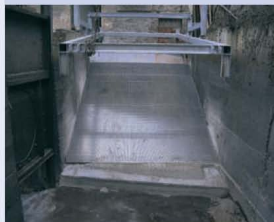
Rechenanlage bei entleertem Oberwasserkanal
